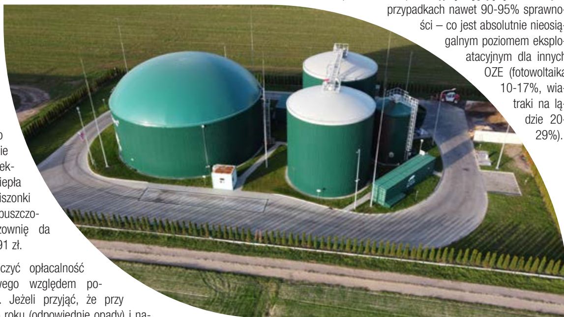
Nowoczesna biogazownia rolnicza w Śniatkiach (0,499 MW mocy el.) zasilana obornikiem, gnojowicą i kiszonką z kukurydzy
